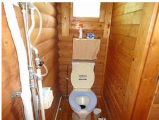
簡易水洗トイレ
