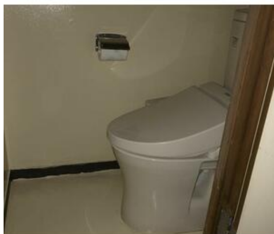
温水洗浄便座付
