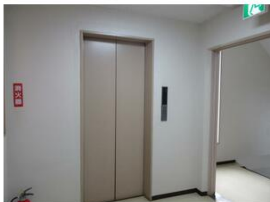
エレベーター
