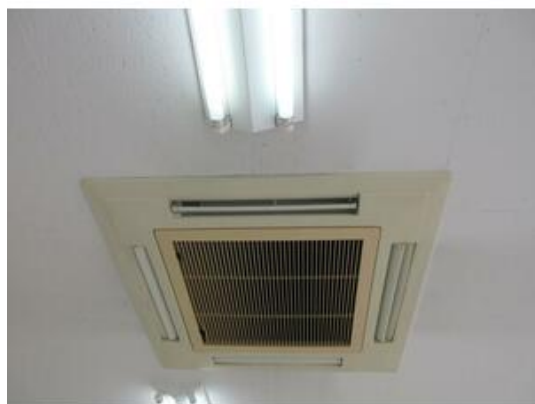
3Aの空調設備
