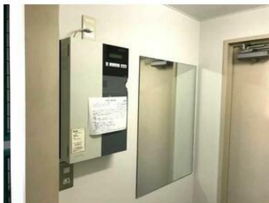
セコム・コントロールパネル
