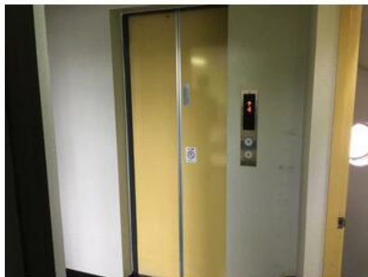
エレベーター1基完備
